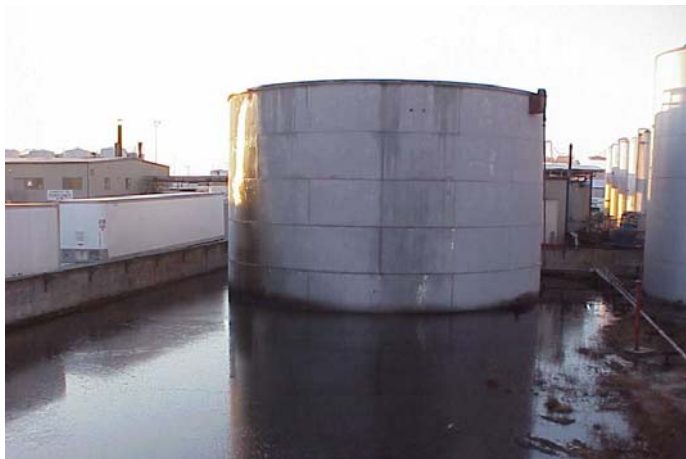
شکل ۹. نقش بانندوال در محصور کردن نفت پس از خرابی مخزن و تخلیه
