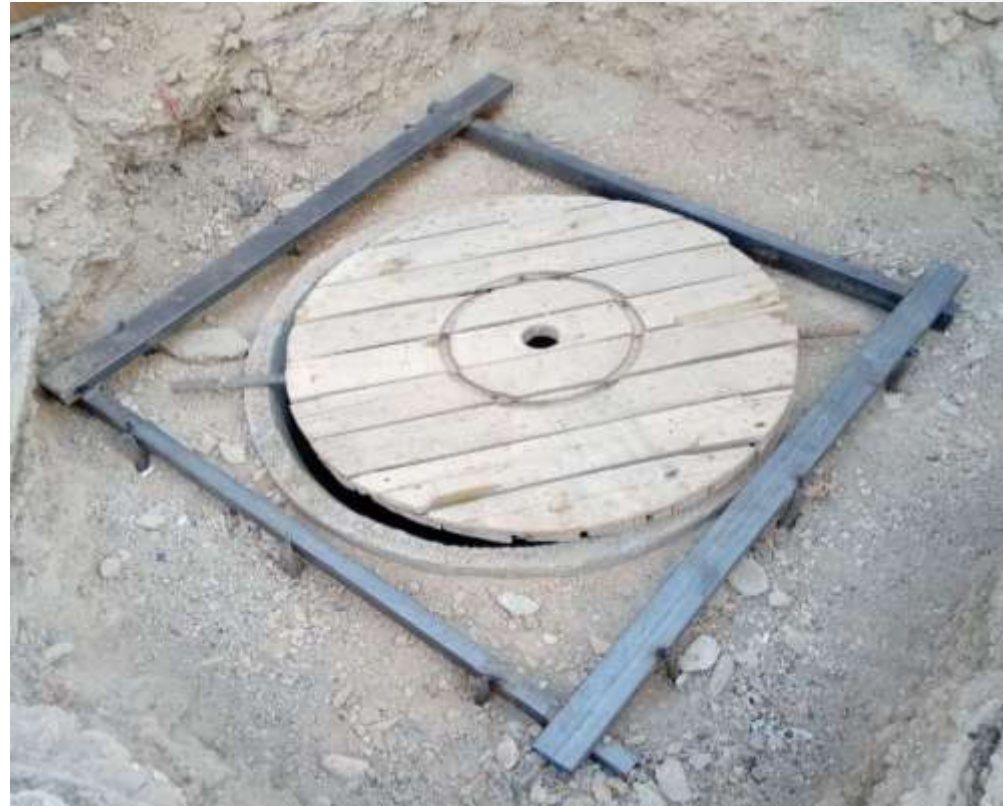
استفاده از درپوش برای چاه
